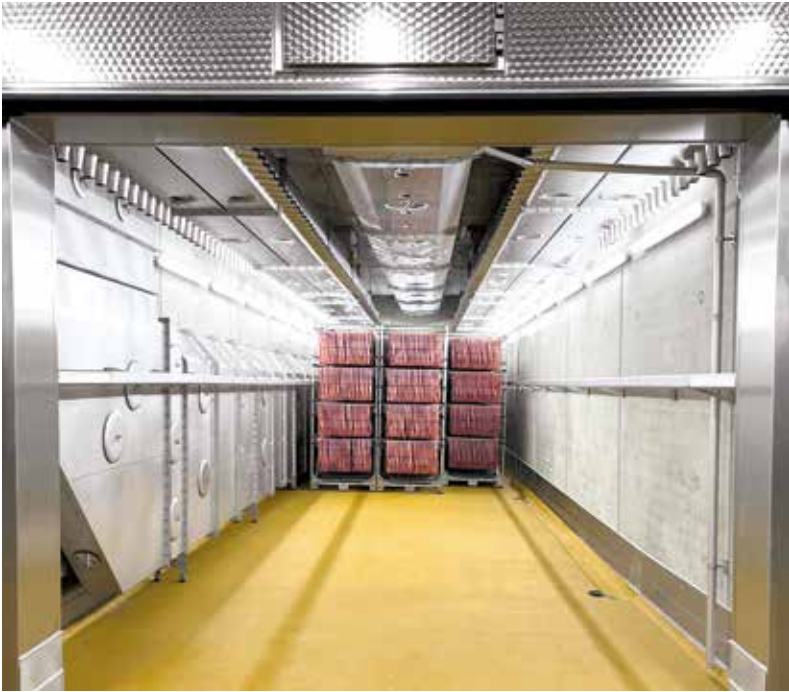
INNENANSICHT der Klimarauchanlagen
