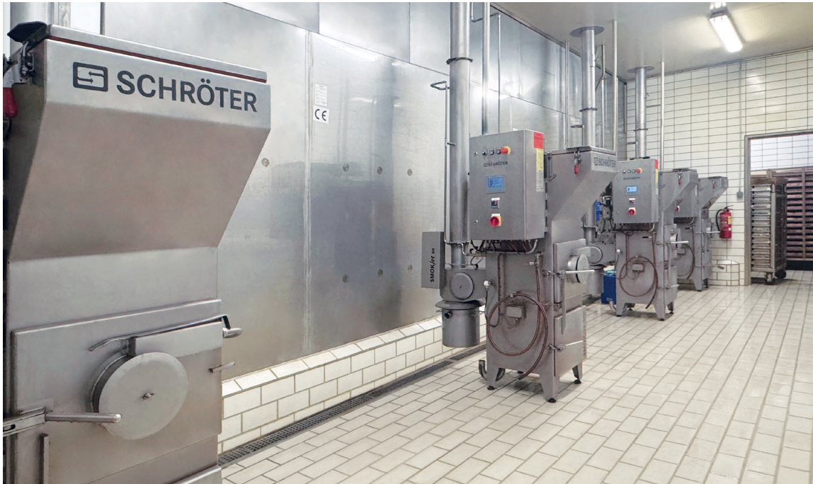
HACKSPÄNE-RAUCHERZEUGER SMOKjet® RH09 hinter den Anlagen
